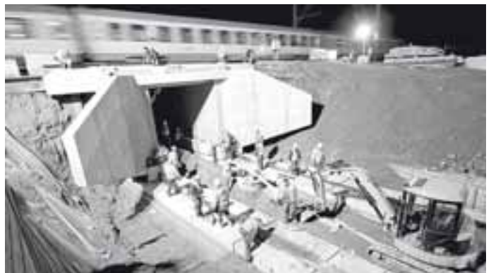
Mitte der Woche befand sich das neue Brückenteil bereits in einbaufertigem Zustand in Warteposition (rechts), während die alte marode Brückkonstruktion noch voll funktionsbereit ihren Dienst versah.
