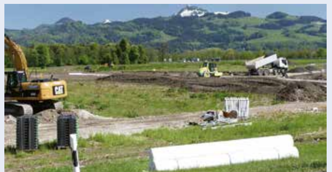
Am Zubringer zur A93 haben jetzt die ersten Bauarbeiten für das neue Gewerbegebiet „Kaiserreich“ in Kiefersfelden begonnen.
