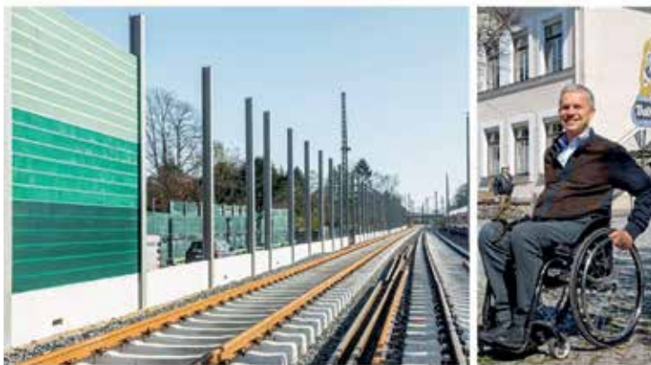
Der Kiefersfeldener Bürgermeister Hajo Gruber freut sich, dass die Schutzwände und Schienendämpfer entlang der Bahnstrecke fertig gebaut sind. © dpa (Scholz)/Ammelburger
